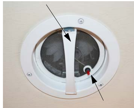
Fan Power Switch
