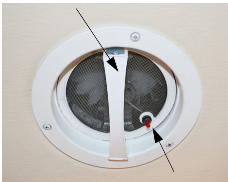
Fan Power Switch
