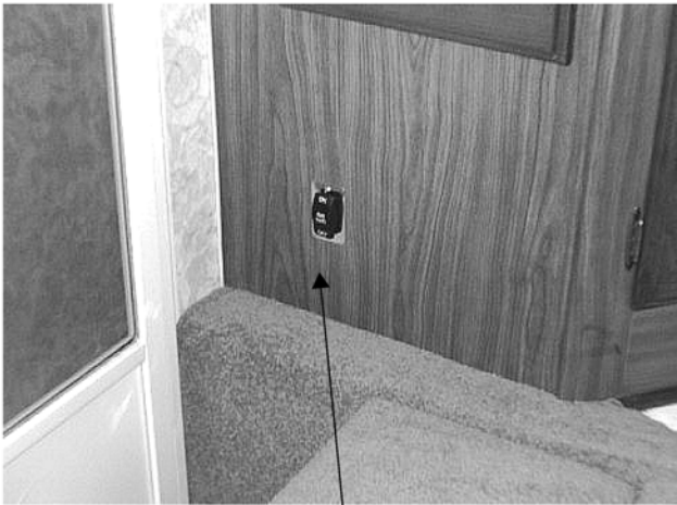
Aux. Battery Switch
